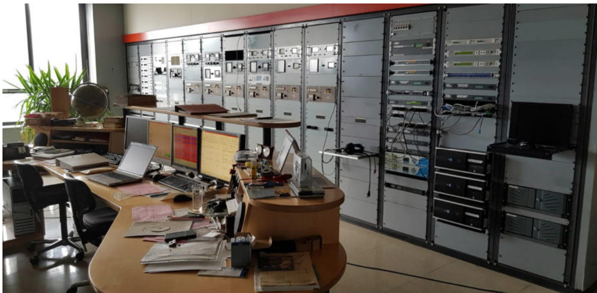
Abbildung 3 Die Sendeanlage von Innen
